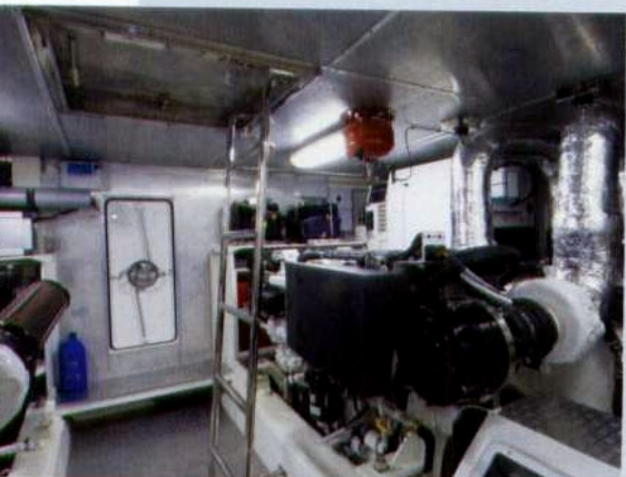
La sala macchine con due Caterpillar C18 che sviluppano 1015 cv ciascuno.
